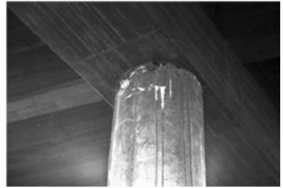
Şekil 6- Köprü ayağında oluşan minör çatlaklar
