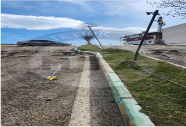
Kırıkhan İlçe Merkezinde sol yanal ötelenmiş yol - MTA Deprem raporu
